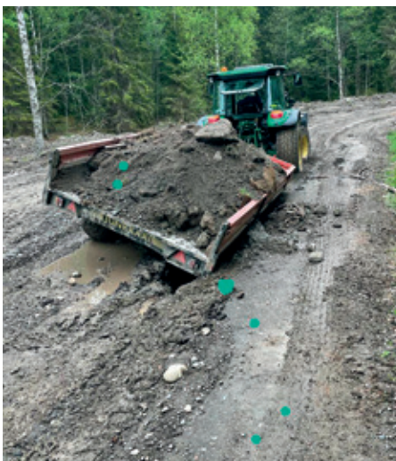
Olisiko sateellakin ollut vaikutusta tien kuntoon konehallin luona remontin aikana
